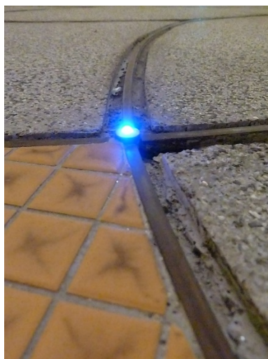
ภาพที่ 12 ไฟ LED แบบฝังไว้ที่พื้น
